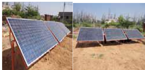
Fig 1 Solar PV Array
